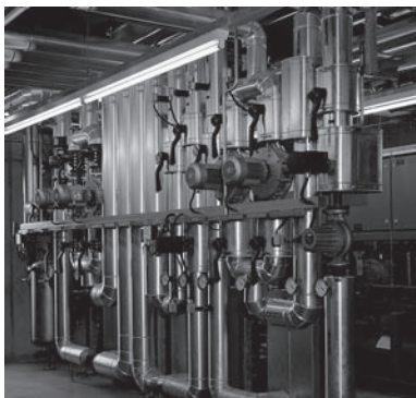
ATV 12 sterowanie stacji pompowej (▲)
