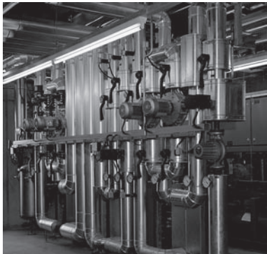
ATV 12 sterowanie stacji pompowej (▲)
